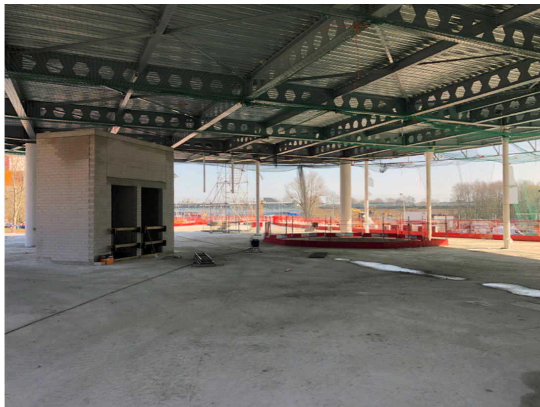
Alle installaties zijn zorgvuldig weggewerkt in de staalconstructie zodat alle aandacht uitgaat naar een goede ontvangst in een rustig en overzichtelijke omgeving met doorzicht naar de entrees en uitzicht op het park.
