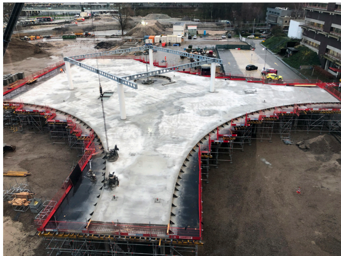
De basis voor de constructie bestaat slechts uit 4 stalen buiskolommen. Deze kolommen zijn met beton gevuld en ingeklemd in de fundering en halverwege hun hoogte ook ingeklemd in de betonconstructie van het voetgangersdek.
